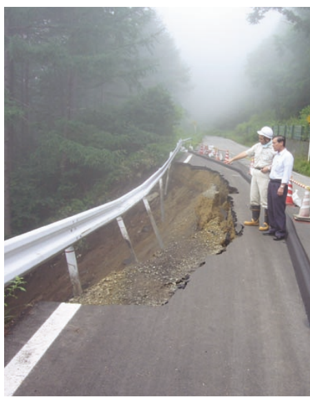
台風4号災害の現場を調査 国道299号(八千穂八郡地区)
